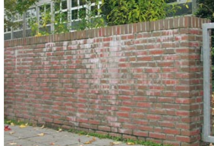
Górną krawędź muru wykonano tradycyjną metodą, czego skutkiem było wnikanie wody deszczowej do muru i powstawanie białych plam na powierzchni muru. Nie zdarzyłoby się to, gdyby zastosowano gotowy element budowlany firmy Röben.
